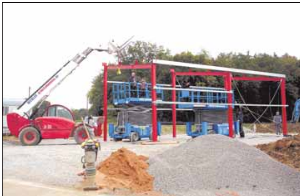
Gut im Zeitplan liegen die Arbeiten zum Aufbau des Nahwärmenetzes in Großscholzheim, das Ende Dezember in Betrieb gehen soll. Am Standort der Heizungszentrale im Grabenweg entsteht eine Stahlhalle mit einer Grundfläche von sechs auf zwölf Metern. Foto: L. Merkle
